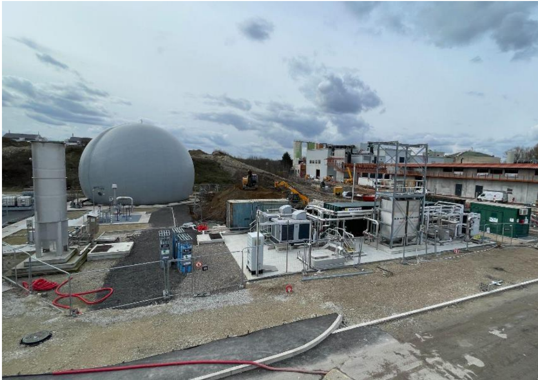
Zbiornik gazu / Pochodnia / Stacja zatłaczania GrDF
